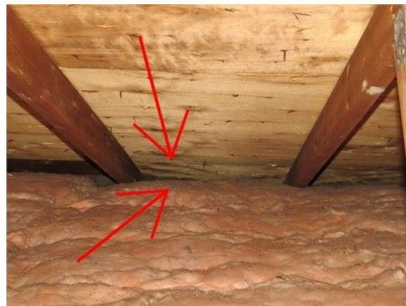
ISOLANT EN CONTACT AVEC LE SOUS-TOIT.
