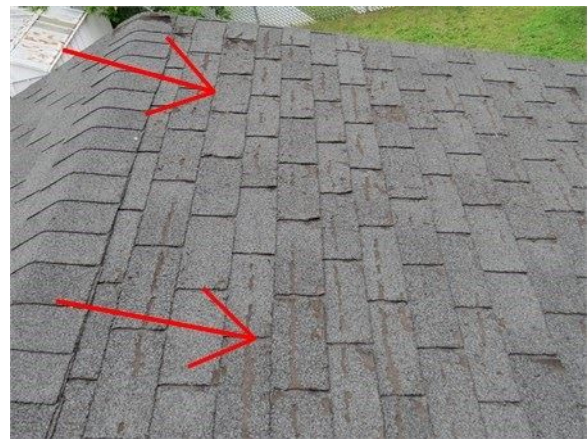
DÉTÉRIORATION DU REVÊTEMENT DE TOITURE.
