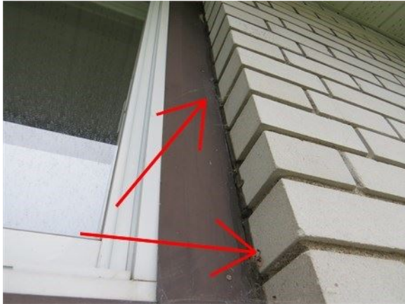
REFAIRE LE SCELLANT AUTOUR DES FENÊTRES.
