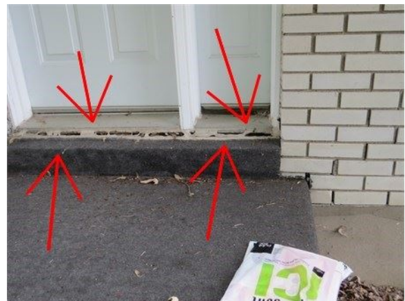
ESPACEMENT DE 1" SOUS LA PORTE AVANT, SIGNE D'AFFAISSEMENT.
