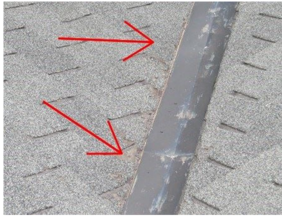
DÉTÉRIORATION DU REVÊTEMENT DE TOITURE.
