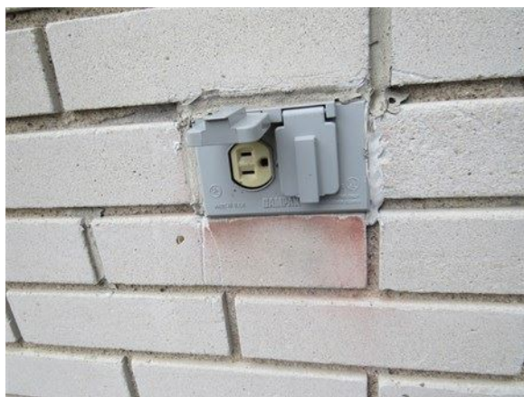
REMPLENER LA PRISE EXTÉRIEUR PAR UNE PRISE DDFT.
