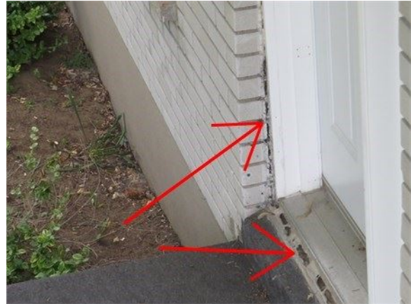
REFAIRE LE SCELLANT AUTOUR DES PORTES.
