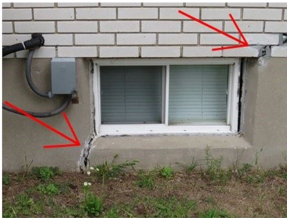
FISSURE IMPORTANTE SITUÉE À LA GAUCHE DU BÂTIMENT.
