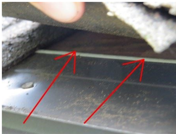
AUCUNE MEMBRANE DE DÉBORD DE TOIT.
