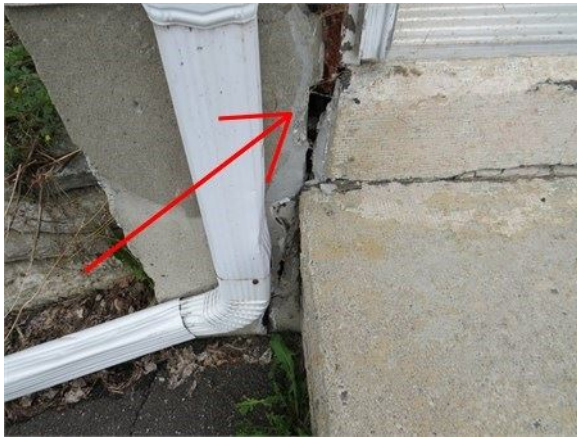
FISSURE IMPORTANTE SITUÉE À LA DROITE DU BÂTIMENT.
