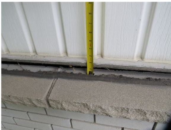
ESPACEMENT DE 1" SOUS LES FENÊTRES AVANT, SIGNE D'AFFAISSEMENT.
